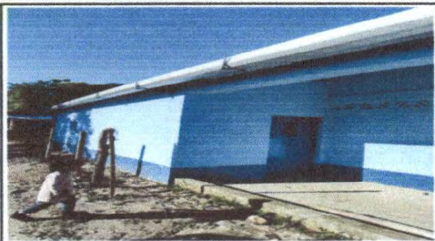
Foto 13: Sustrucción de canal de metal
